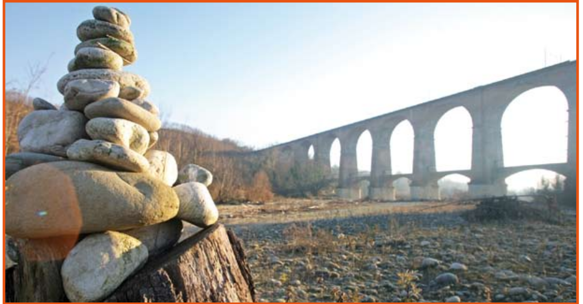
Un'immagine del ponte ferroviario con la pedancola recentemente riattivata (foto di Walter Lamberti)
